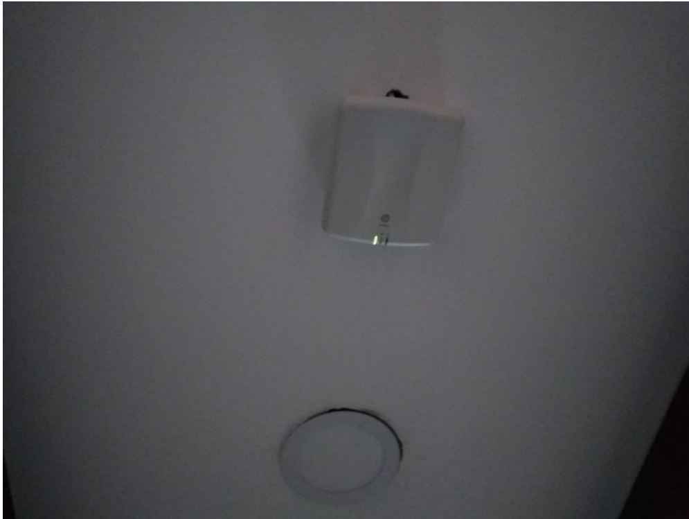
Şekil 3.12. Ramada Otel Koridorunda Yer Alan WI-FI Sistemi
